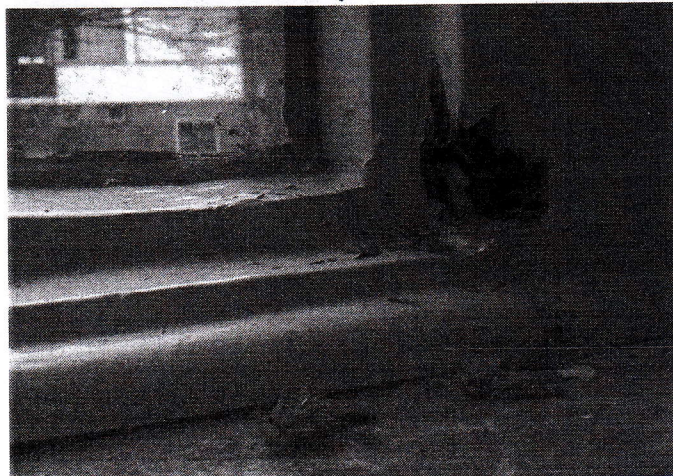
de houten kozijnen rotten weg waar je bij staat
